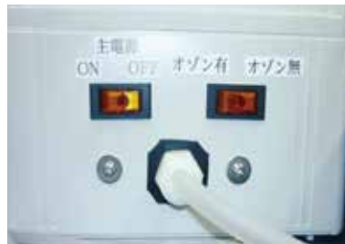
図2 オゾン発生装置スイッチ
